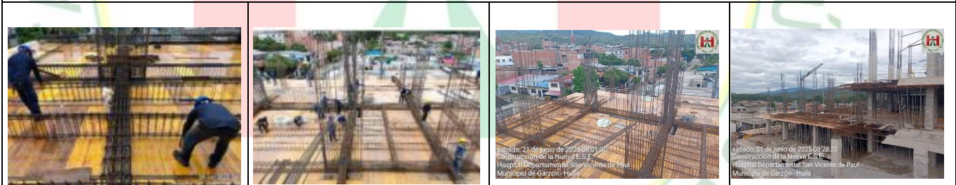
ARMADO DE ESTRUCTURA DE SOPORTE, ACEROS DE REFUERZO DE VIGAS Y VIGUETAS, INSTALACION DE CASETONES Y FUNDIDA DE PLACA 2 PISO DE LOS EJES 7-11 AL A-F
