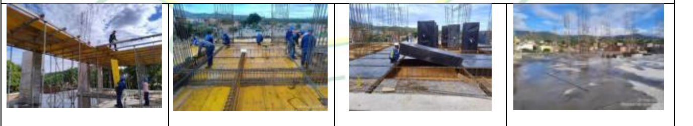
ARMADO DE ESTRUCTURA DE SOPORTE, ACEROS DE REFUERZO DE VIGAS Y VIGUETAS, INSTALACION DE CASETONES Y FUNDIDA DE PLACA 3 PISO DE LOS EJES 1-4 AL B-F
