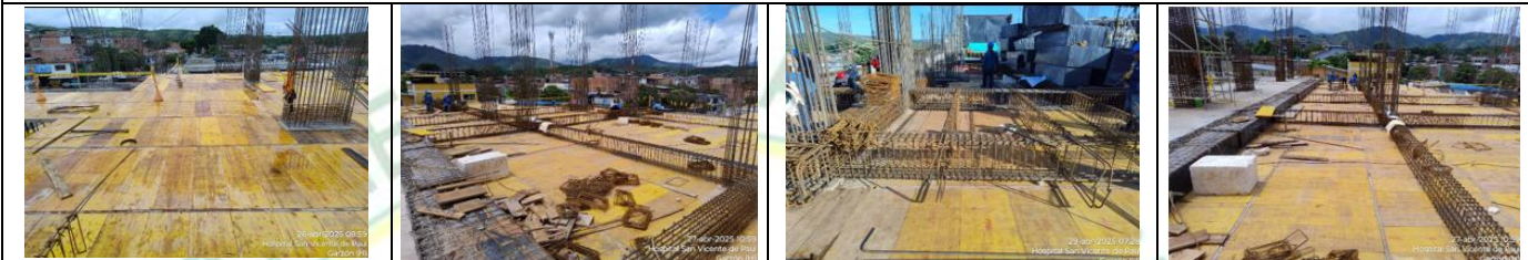
ARMADO DE ACERO DE REFUERZO PARA VIGAS AERIAS 2 NIVEL DE LOS EJES 4 AL 7 ENTRE LOS EJES A AL F ACTIVIDADES LOTE B
