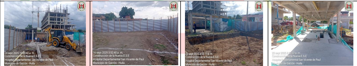
NIVELACIÓN Y ADECUACIÓN DE TERRENO PARA FUNDIDA DE PLACA DE CONTRAPISO EN SUBESTACIÓN DEL EDIFICIO 1 EN LOTE B, DE IGUAL MANERA FUNDIDA DE CÁRCAMOS Y CAJAS ELECTICAS DEL ÁREA DE SUBESTACIÓN, SE REALIZO CERRAMIENTO EN LAMINA EN LOTE B PARA EDIFICIO 3 EN ÁREA DE TANQUE DE RCI, SE REALIZO EXCAVACIÓN MANUAL Y ADECUACIÓN DEL TERRENO PARA TANQUE DE RCI EN LOTE B.
