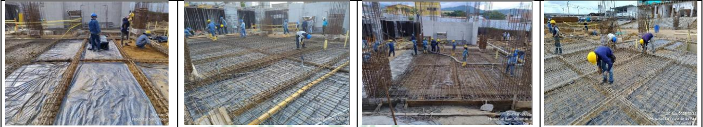
ARMADO DE ACERO DE REFUERZO PARA VIGAS, RÍOSTRAS Y PLACA DE CONTRAPISO DE LOS EJES 6 AL 9 ENTRE LOS EJES A AL F
