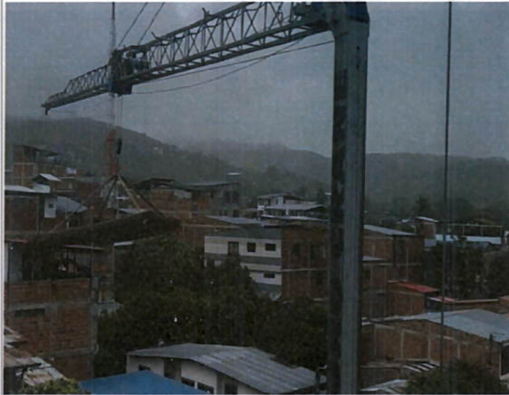
Ilustración 30. Grúa auto desplegable
