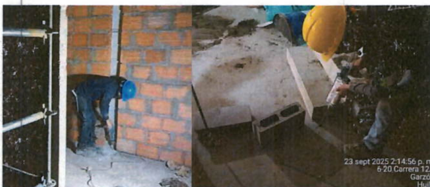
Ilustración 4 Anclaje de dovelas y elementos no estructurales
